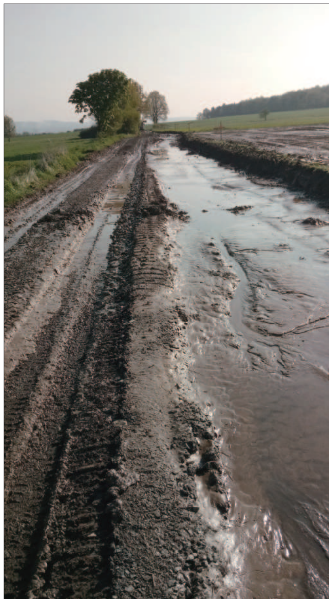
Erozní událost z 6. 6. 2017 jako následek dvouhodinové bouřky na dlouhém svahu s kukuřicí. Plošná až brázdová eroze poničila rozestavěnou polní cestu při realizaci komplexní pozemkové úpravě v Želčanech . (foto 6. 6. 2017).
