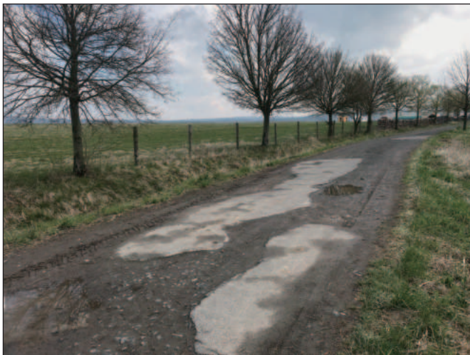
Stav polní první polní cesty z roku 1992. Kryt z recyklované drtě nevydržel dopravu těžkých mechanismů a byl vyspraven asfaltbetonovou směsí. Stromořadí je vitální a udržované obcí. V roce 1998 byla cesta propojena na polní cestu ve Chválenicích vybudovanou v rámci JPU (foto 22. 4. 2022).
